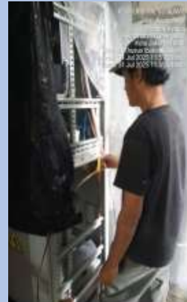
Koneksi kabel listrik panel PUTR lantai 1
